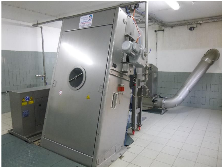
Neue Rechenanlage mit mehr Platz im Rechenhaus
