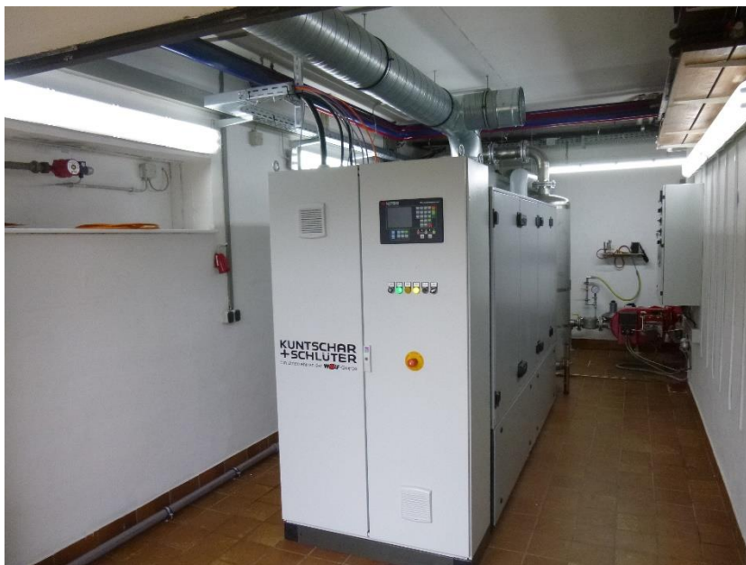
BHKW im Heizraum, hinten der Brenner
