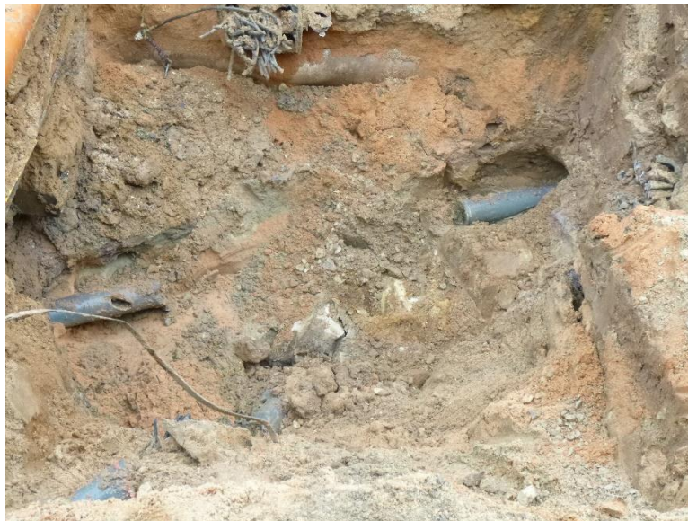
Bruchstelle der Schlammdruckleitung
